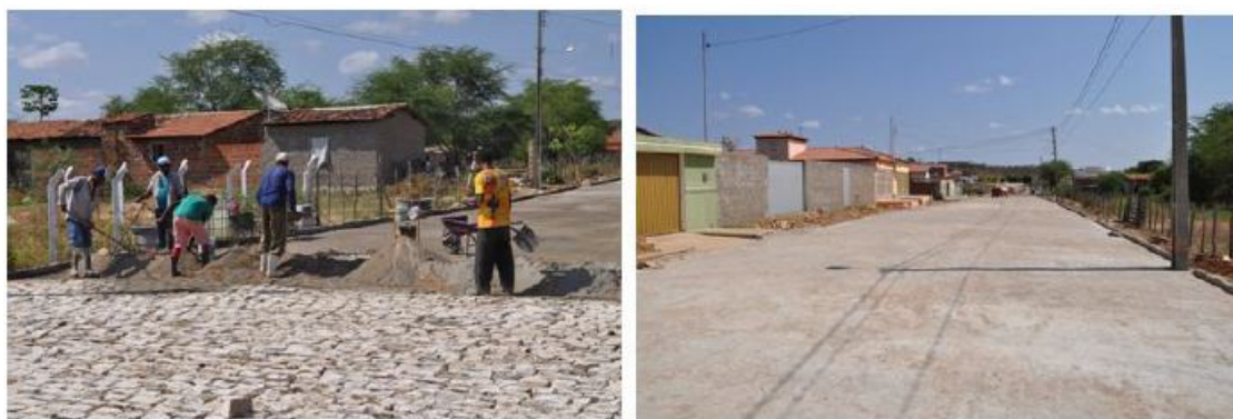
Figura 15. Rua José Paulino do Rêgo, localizada no bairro João XXIII Fonte: Autores (2011)
