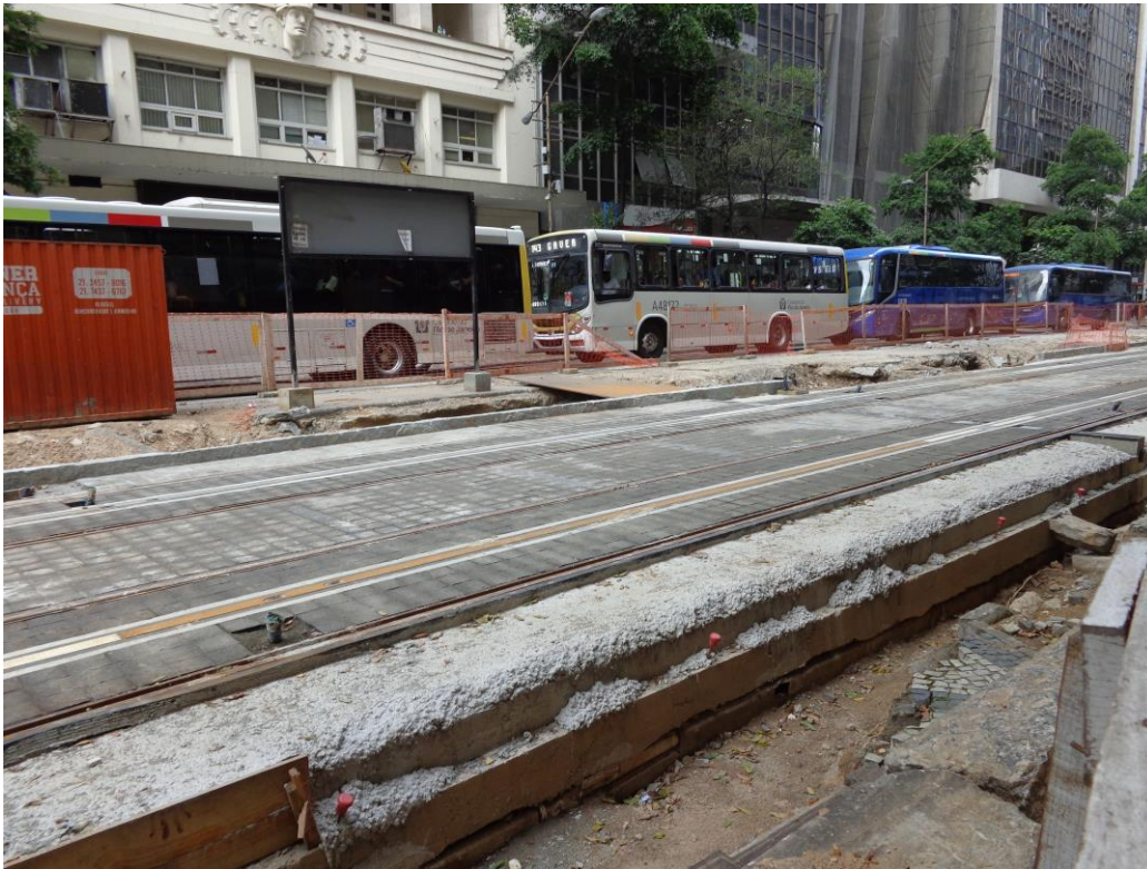
Foto 3: Implantação da via permanente para o VLT na Av. Rio Branco. Foto: Mauro Kleiman
